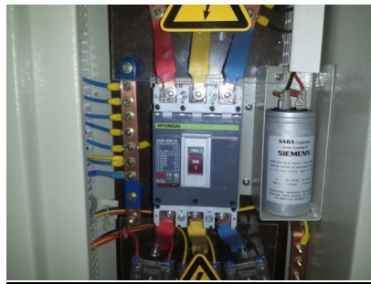
شکل (2): نمایی از بخش ورودی تابلو و نحوه نصب خازن
