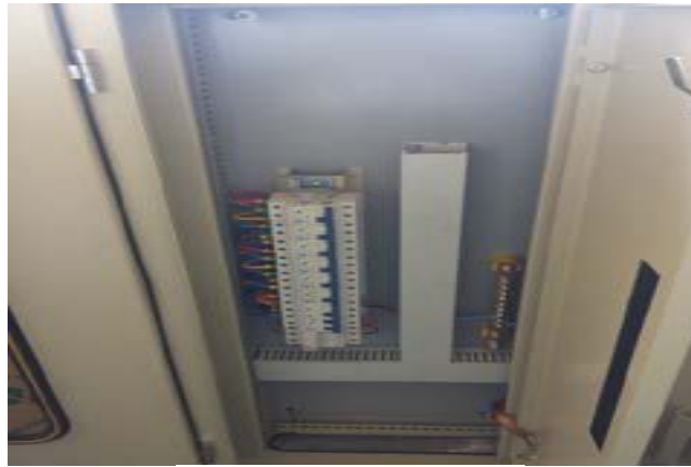
شکل (7): نمایی از بخش خروجی تابلو
